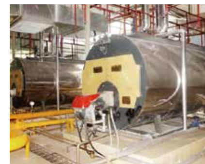
改造前 3台 3t/h，两用一备 占地约 320 m 2
